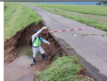
被災状況調査の様子 （秋田）
