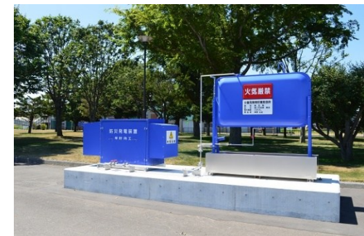
非常用自家発電装置 (本社敷地内)
