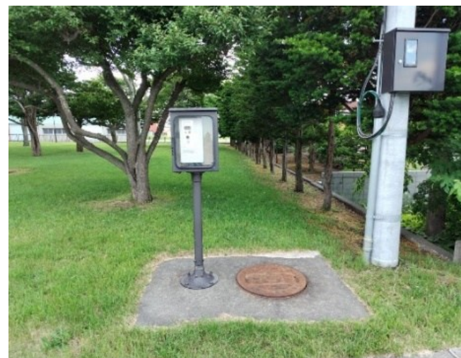
非常用地下水（本社敷地内）
