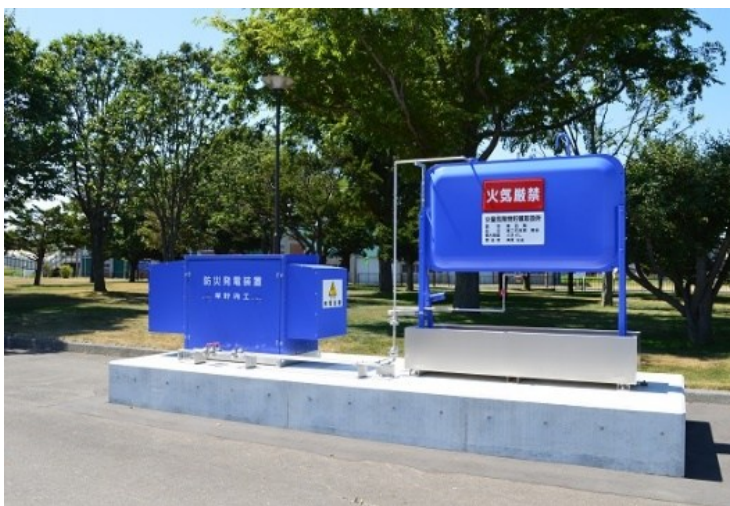
非常用自家発電装置（本社敷地内）
