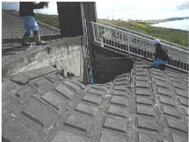
樋門周辺護岸の陥没
