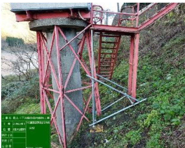
河川管理施設の応急補修 (管理橋が劣化しているため、 単管パイプで応急補修)
