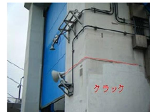
門柱コンクリートの亀裂
