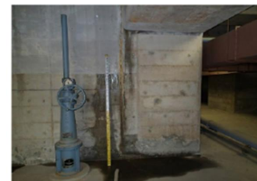
地下ポンプ室の漏水
