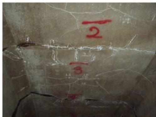
吐出樋門函体の白華現象と亀裂
