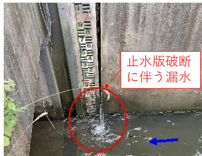
接続水路接続部の開き
