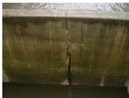
吐出水槽の漏水・亀裂
