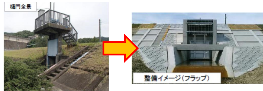
樋管ゲートの無動力化（フラップ化）
