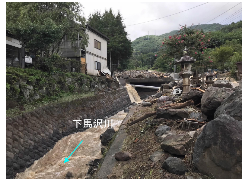
図 下馬沢川上流区間の被災状況
