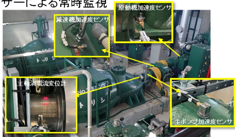
排水ポンプにセンサーを設置して運転データを監視
