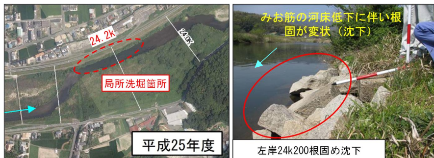
図 4-6 局所洗掘による根固め工の変状事例
