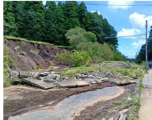
法面崩れ(千葉県千葉市緑区)
