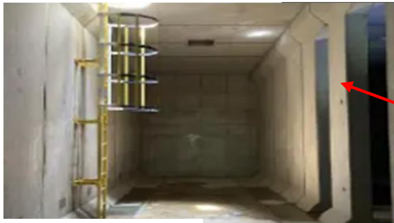
みつわ台雨水貯留槽 貯留量: 7,500m 3
