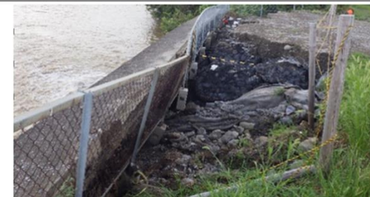
農業用堰 護岸の崩落 (市原市)
