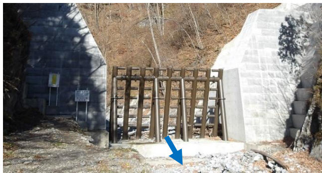
土石流発生前(R5年11月撮影)
