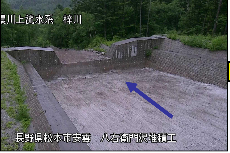
土砂流出発生前 (R6.6.21)
