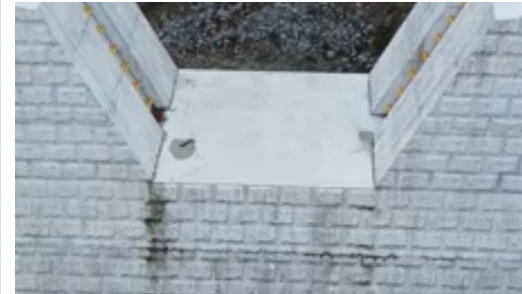
変状レベルa(摩耗)
