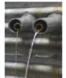
波形集水管が採用された集水井内部
