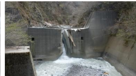
健全度 要対策:C
