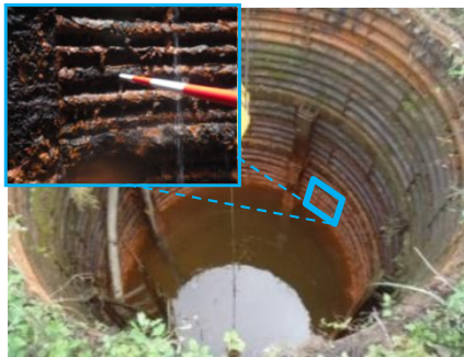
老朽化により内壁の腐食が進行
