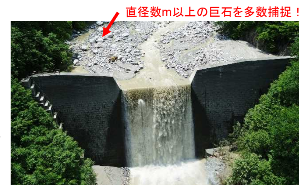
飯島第6砂防堰堤の捕捉状況
