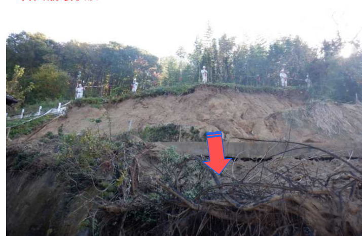
斜面崩壊状況
