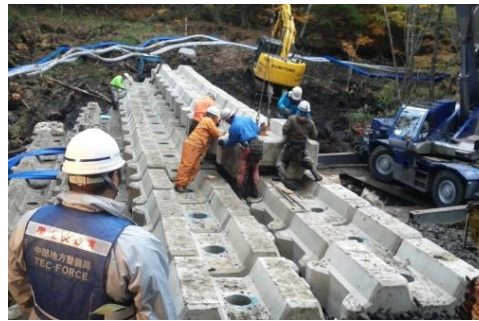
ブロック砂防堰堤の設置
