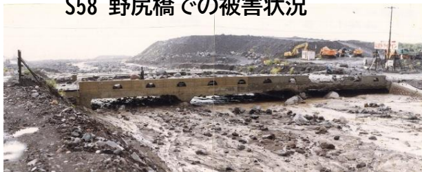
S58 野尻橋での被害状況
