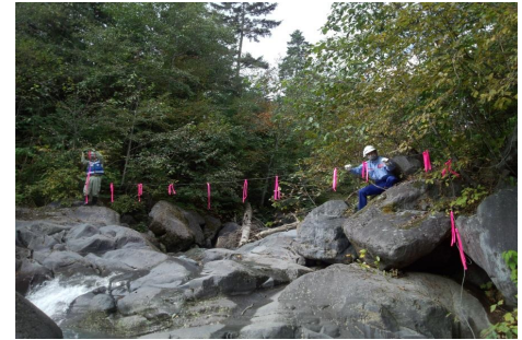
土石流を感知するワイヤーセンサーを設置
