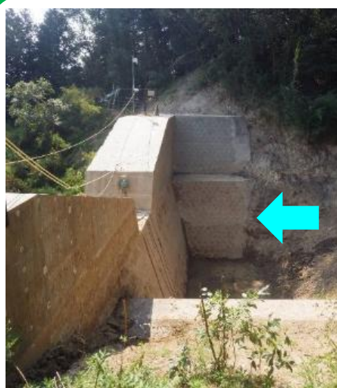
土砂撤去後 (R2. 8. 24)
