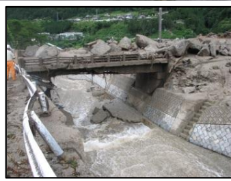
■梨子沢橋 被災状況
