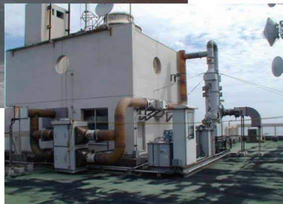
三宅支庁脱硫装置
