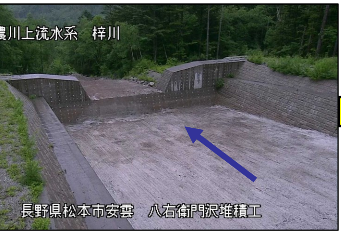
土砂流出発生前 (R6.6.21)
