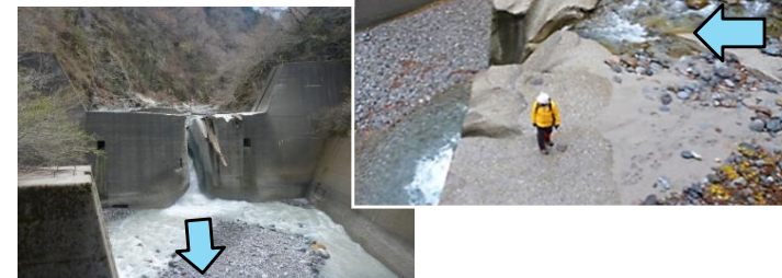
砂防堰堤水通しの摩耗 (施設完成から約60年時点)
