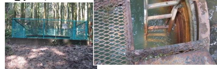
排水不良による集水井湛水 (施設完成から約30年時点)
