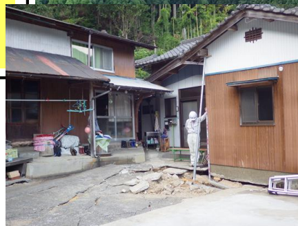
①基礎の沈下、建物傾倒
