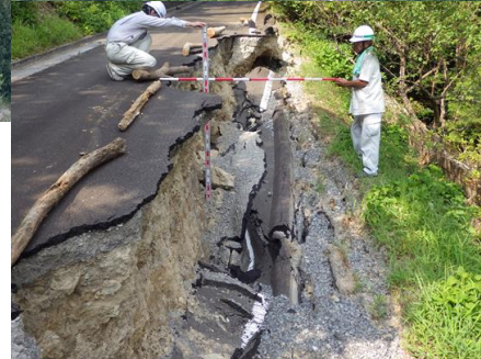
②市道桑内白川線の被災箇所
