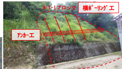
被災箇所 全景 (A-1-1)
