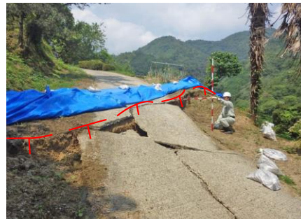
②私道の被災状況 (A-2ブロック)
