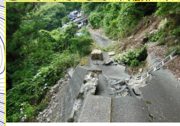
Aブロック頭部の滑落崖
