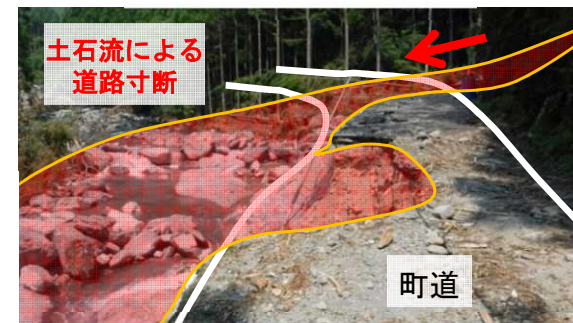
町道寸断による孤立の発生(立川川)
