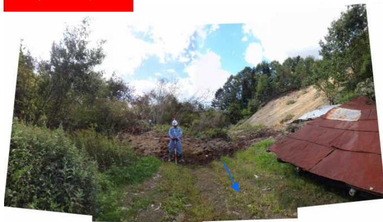
土砂流出状況
