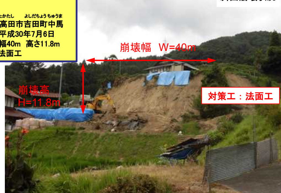
斜面崩壊状況
