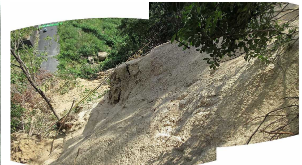
②斜面崩壊状況
