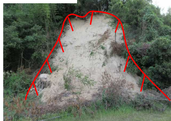
①斜面崩壊状況
