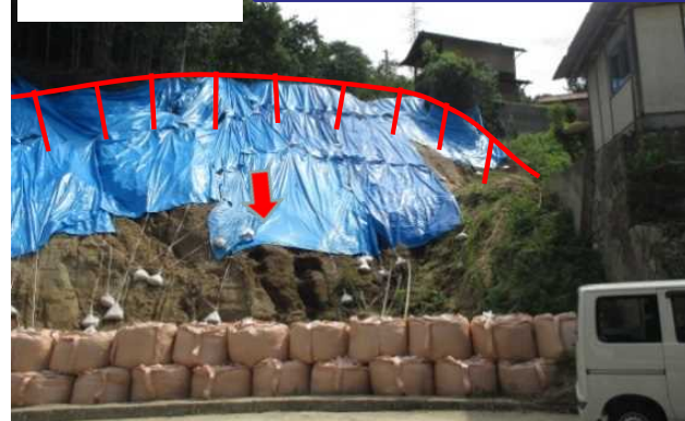
斜面崩壊状況
