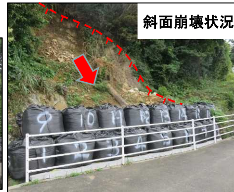
斜面崩壊状況
