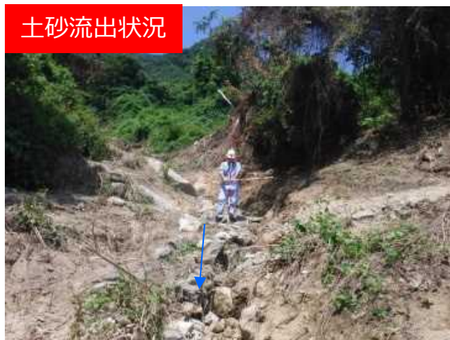
土砂流出状況
