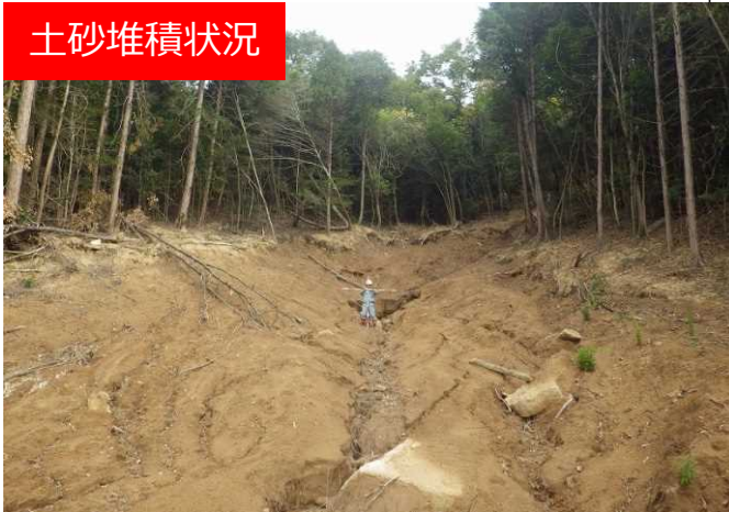
土砂流出状況
