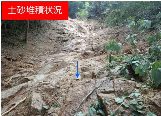
土砂流出状況
