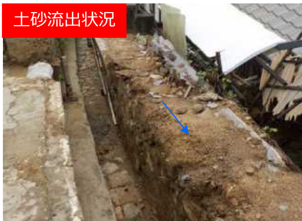
土砂流出状況
