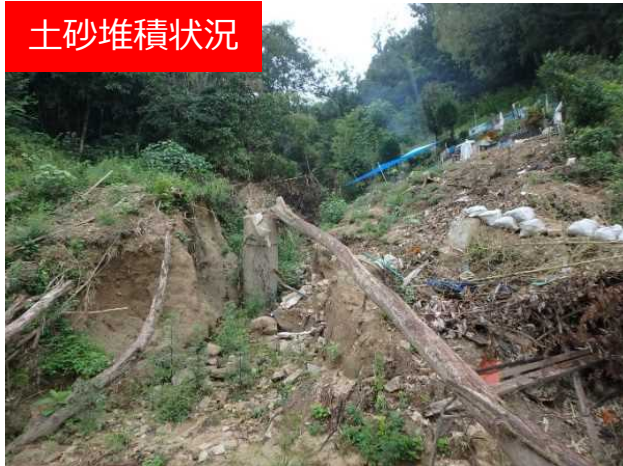
土砂流出状況
