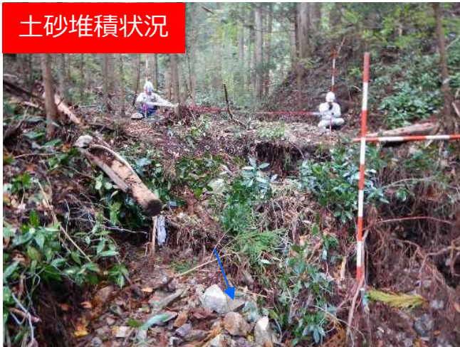
土砂流出状況
