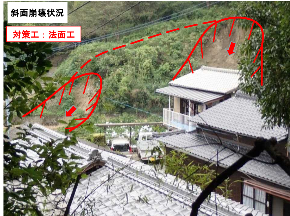
斜面崩壊状況
