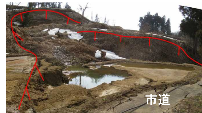
被害状況②
