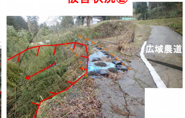
被害状況②
