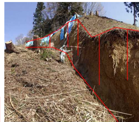
②側方滑落崖の状況
