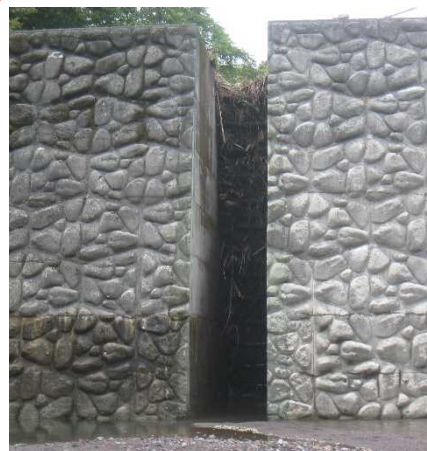
右岸側スリット 流木捕捉状況
