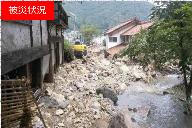
土砂堆積状況
