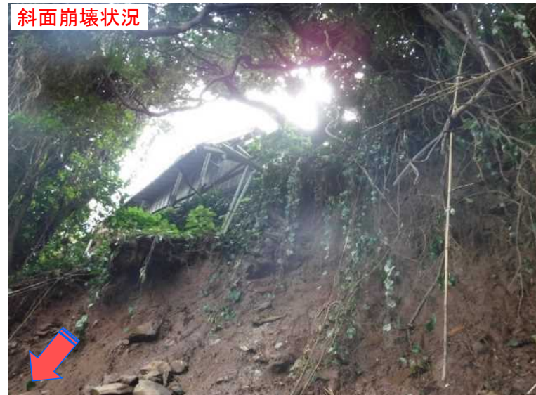
斜面崩壊状況
