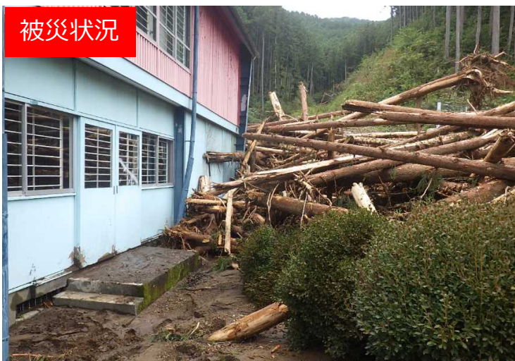
不安定土砂堆積状況
