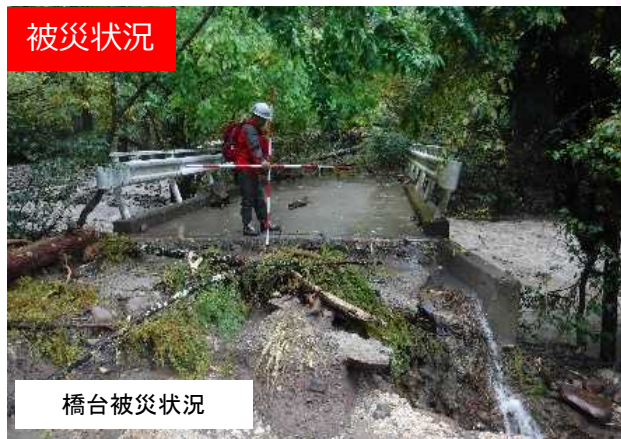
不安定土砂堆積状況
