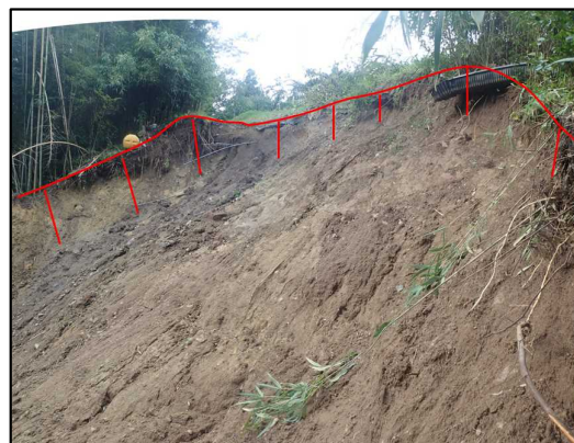
被害状況①(滑落崖の状況)
