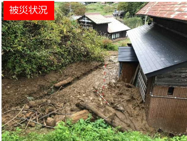
不安定土砂堆積状況
