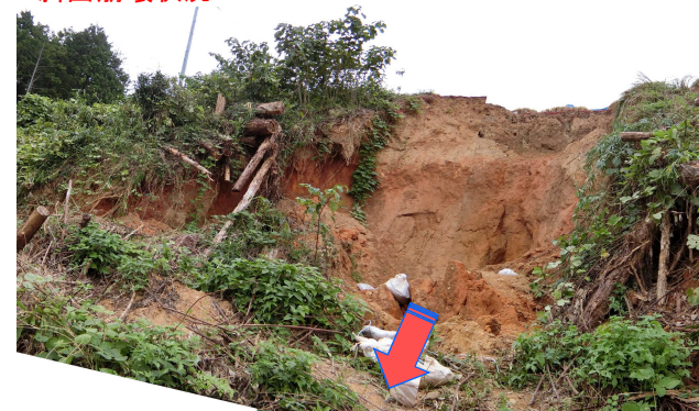
斜面崩壊状況
