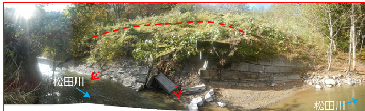
既設護岸工の被災(末端部)
