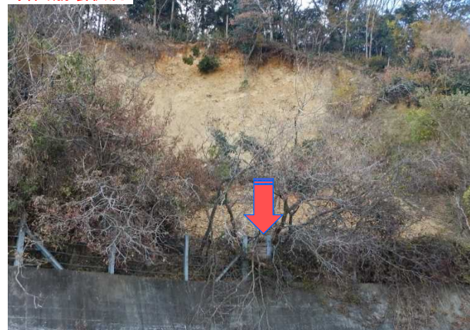
斜面崩壊状況
