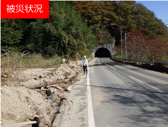
不安定土砂堆積状況
